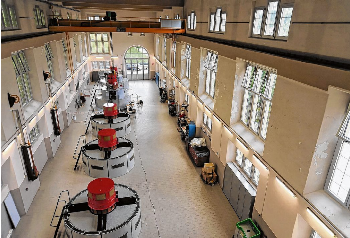
Das Ölberg-Kraftwerk versorgt die Stadt Freiburg seit mehr als 100 Jahren mit Strom.
